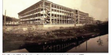
Le 24 août 1939, la pierre d'angle est posée et l'on commence les travaux.
